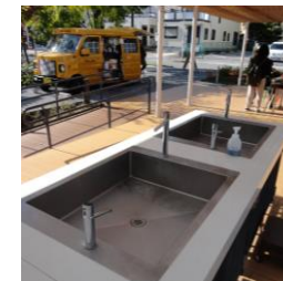
日常的に利用可能な給排水設備／岡崎市
