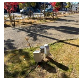
催事に利用可能な給電設備の設置／大東市
