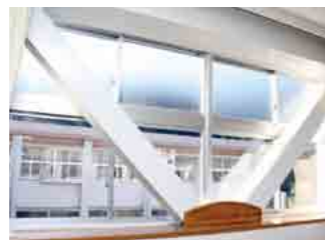
小中学校耐震補強事業 事業規模／中学校5か所 事業費／1億4,395万円 実施地区／横川・霧島・福山
