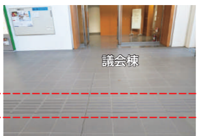
議会棟前の点字ブロックの状況
