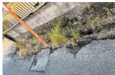
老朽化の進む側溝
