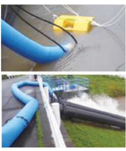
移動式ポンプ稼働状況
